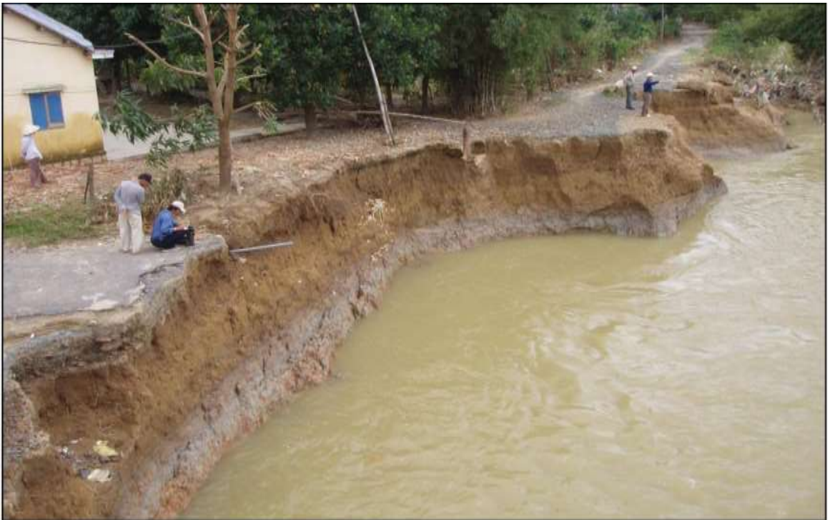
Hình 3.24: Xói lở bờ sông Dinh – Ninh Hòa đoạn xã Ninh Phú (Ảnh Mai Văn Cảnh 2015)
